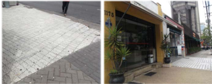
Figura 174 - Falta de padronização das calçadas da Berrini. Fonte: Acervo pessoal, 2012.
