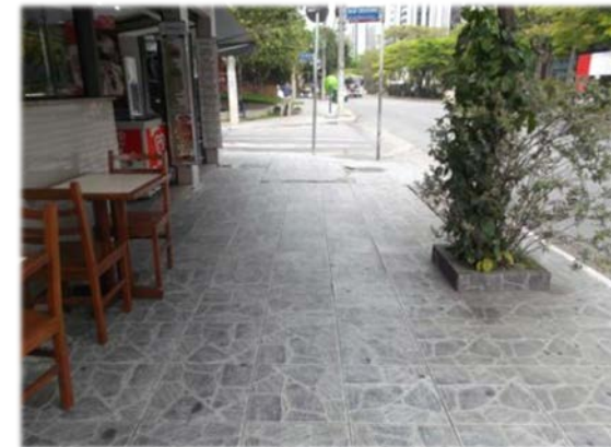
Figura 176 - Calçada com piso feito em cerâmica, material escorregadio considerado inadequado. Fonte: Acervo pessoal, 2012.
